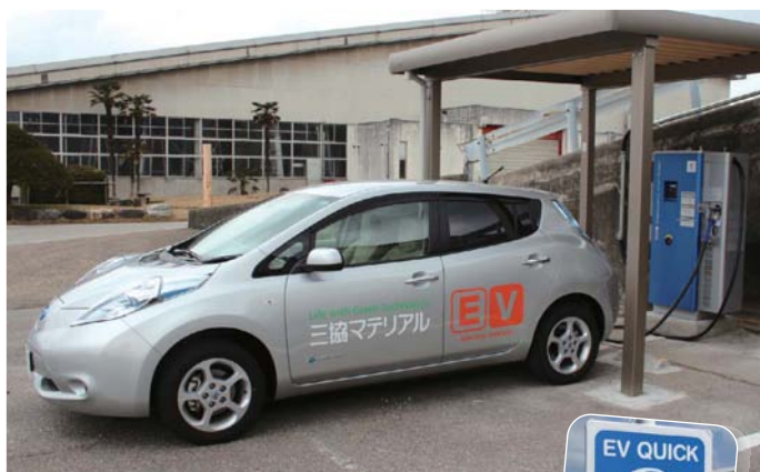
急速充電器設備と電気自動車
