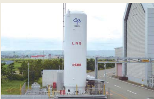
LNG供給設備
