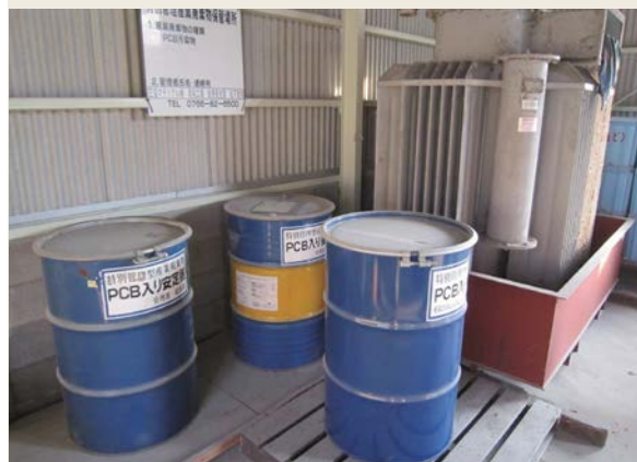
PCB含有物の保管(奈呉工場)
