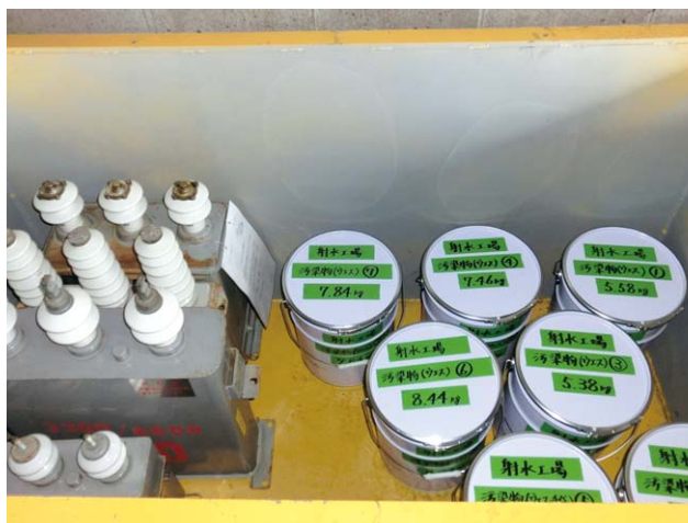
PCB含有物の保管(奈良物流センター)
